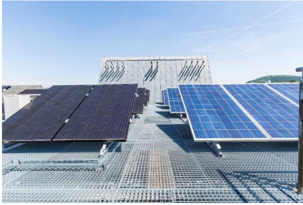
Abbildung 8 PV-Anlage auf Gebäude 33
